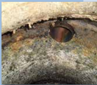
Betonwand korrodiert, fehlendes Prallblech
